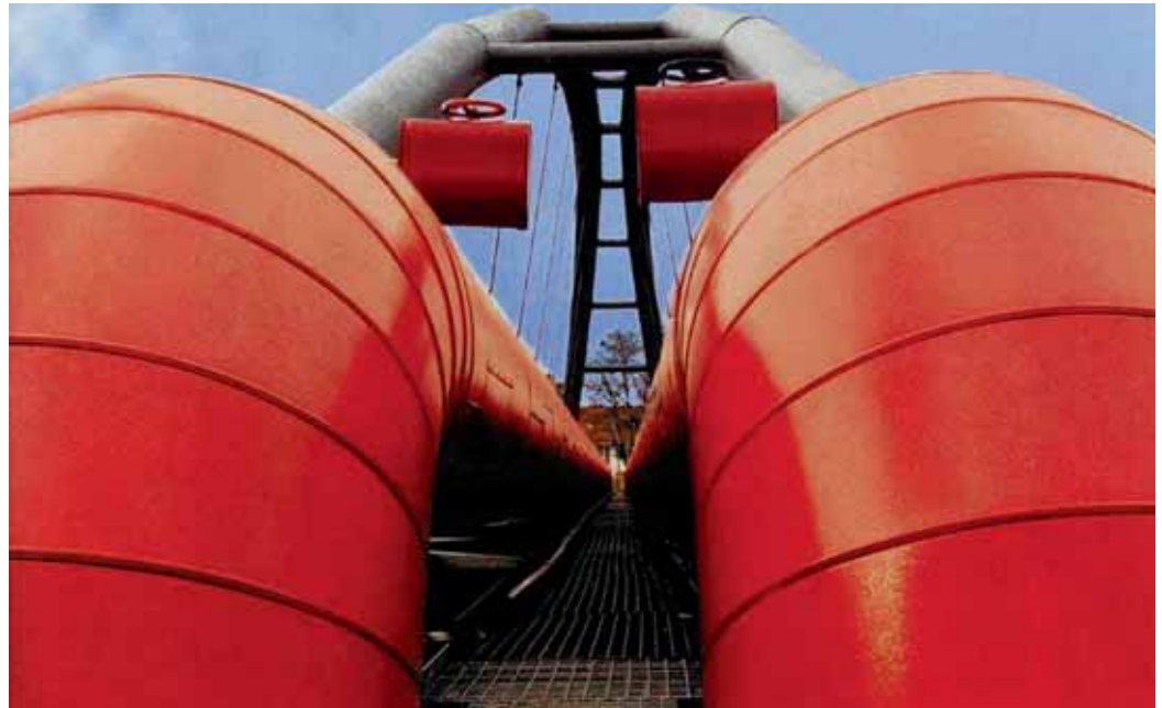
Fernwärmerohre in Mannheim: Sie sind Teil eines 750 Kilometer langen Leitungssystems, das sich von Mannheim-Sandhofen im Norden den Rhein entlang bis Brühl erstreckt.
