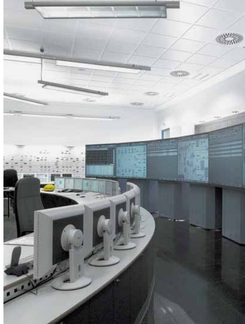
Alles im Blick: Moderne Leittechnik sorgt im Großkraftwerk Mannheim für den reibungslosen Betrieb des 2006 umgerüsteten Block 6. Bild: GKM
