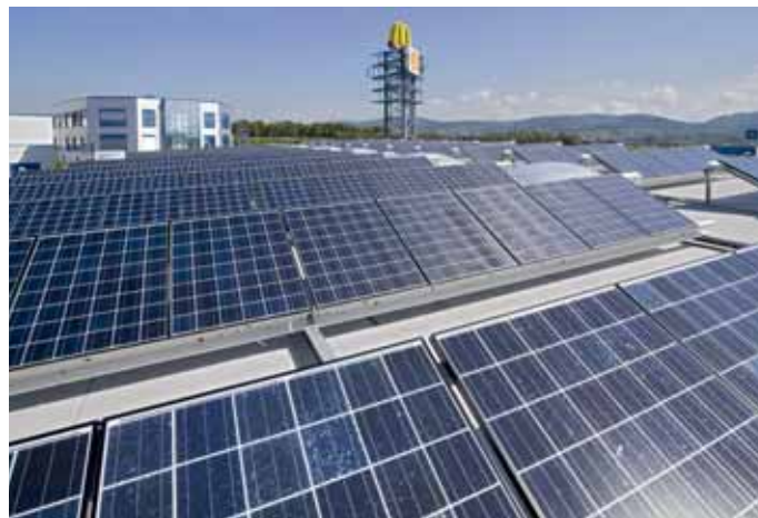
Eine von Goldbeck Solar im Hirschberger Gewerbegebiet installierte Solaranlage. Sie steht auf dem Dach des „Apart factory store“. Bild: Goldbeck
